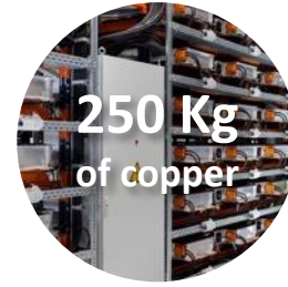
per MW stored
